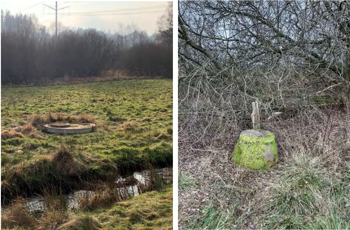
Figur 32 Brønd nr. 2 (th) og brønd nr. 5 (tv) på afvandingsystem 12.
