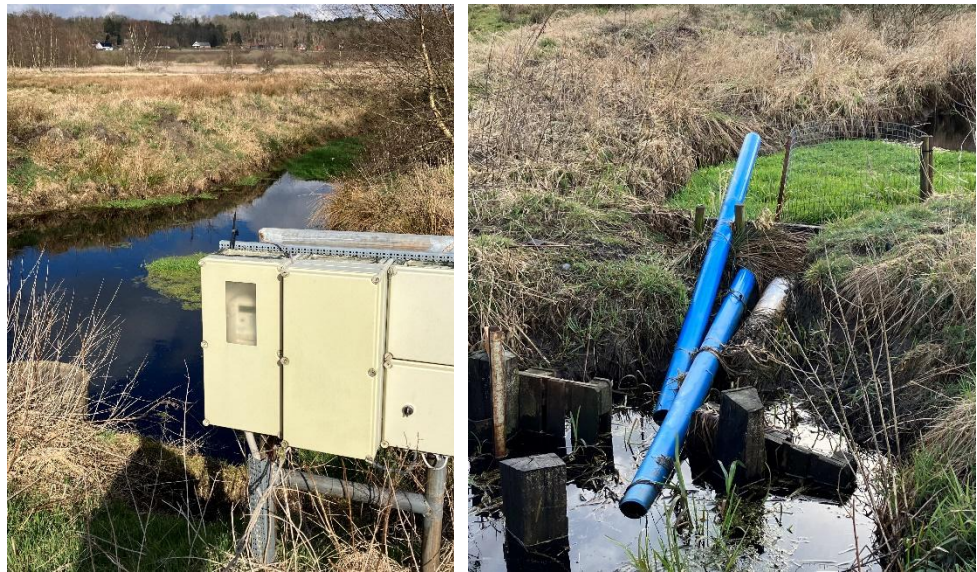
Figur 4-12: Tv. Vandindvindingsanlæg i system 15. Th. Opstemning i grøften, som styrer vandstanden ved indvindingsanlægget.
