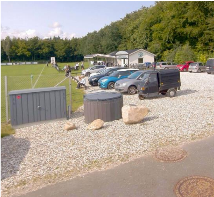
Figur 4-11 Foto af mulig pumpestation og styreskab.
