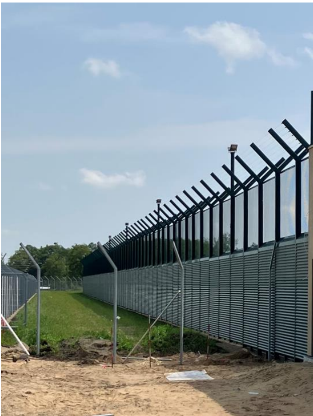
Figur 4-9 Eksempel på perimetersikring i hegn med lukkede felter set udefra.
