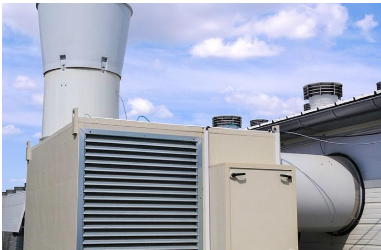
Varmeveksler som placeres mellem bygningerne.
