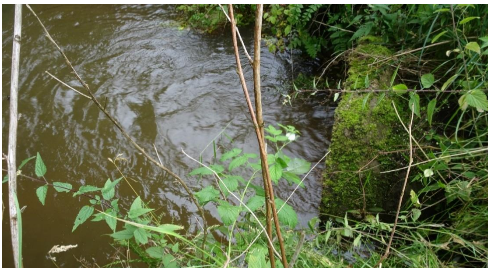
Figur 7. Styrt ved rørbro i st. 6.476.
