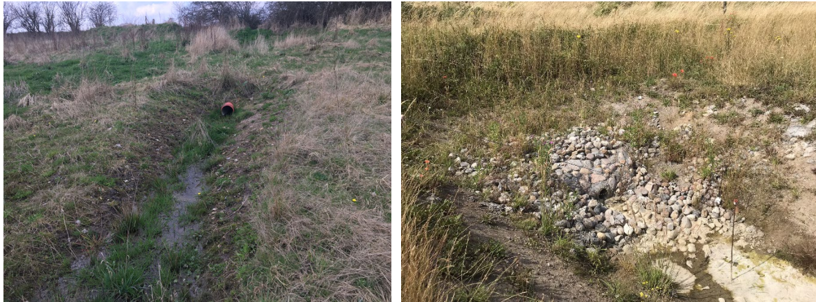
Foto 3 Eksempler på afbrudte dræn som er ført til overrisling.
