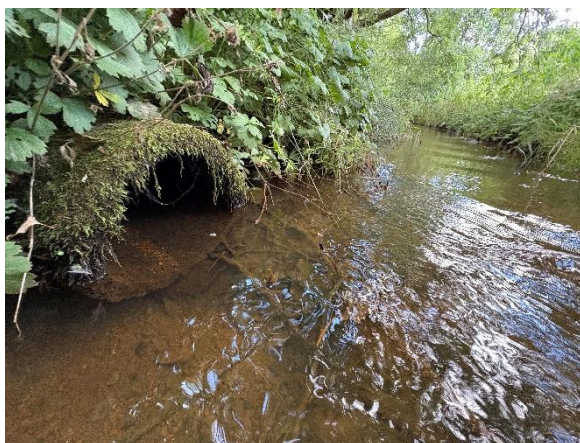
Figur 9 Der findes en enkelt drænuddløb, som der vil blive taget hensyn til, ikke bliver påvirket af de udlagte sten.
